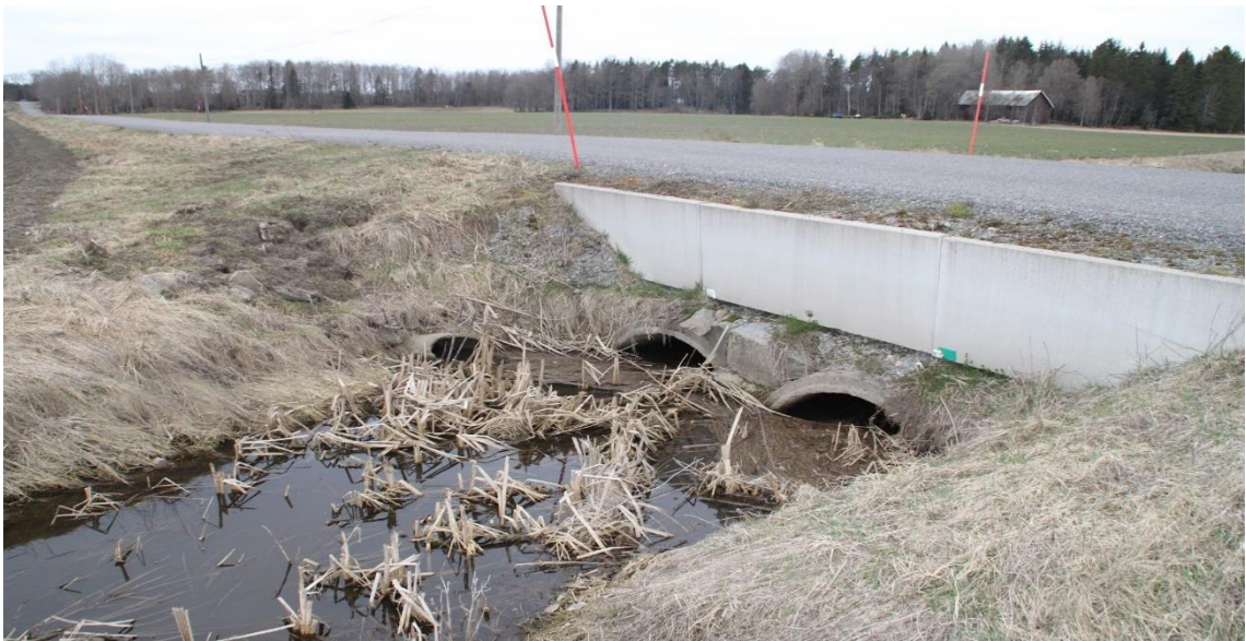
Figur 32. Exempel på vägsituation där det borde vara räcke, situation 7 väg 631.
