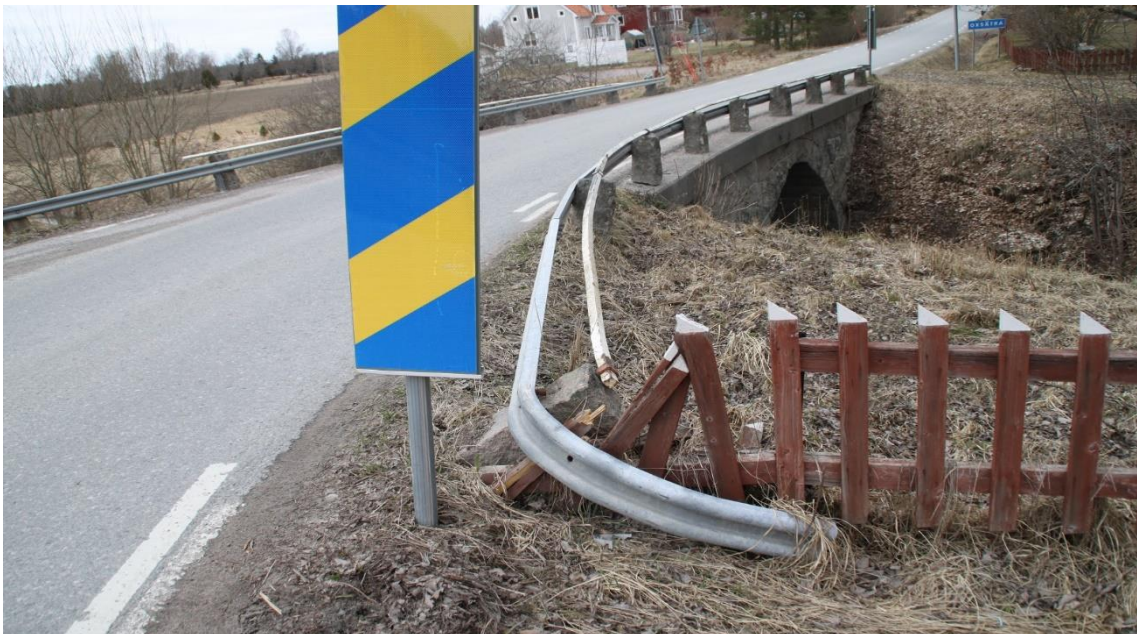
Figur 26. Exempel på trasig räckesände på broräcke som inte uppfyller nuvarande standarder, situation 9 väg 631.
