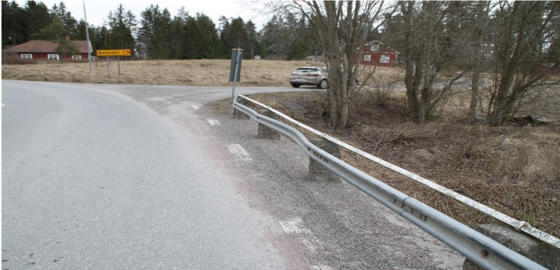
Figur 7. Exempel på skadad räcketbalk på broräcke som inte uppfyller nuvarande standarder, situation 9 väg 631.
