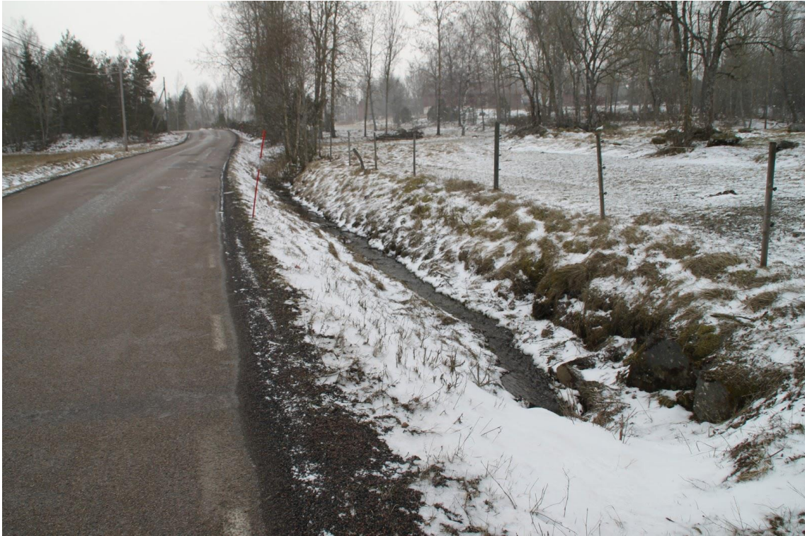
Figur 20. Exempel på brant dike, situation 2 väg 1120.
