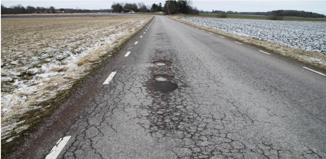
Figur 38. Exempel på trasig beläggning på vägen, situation 4 väg 631.
