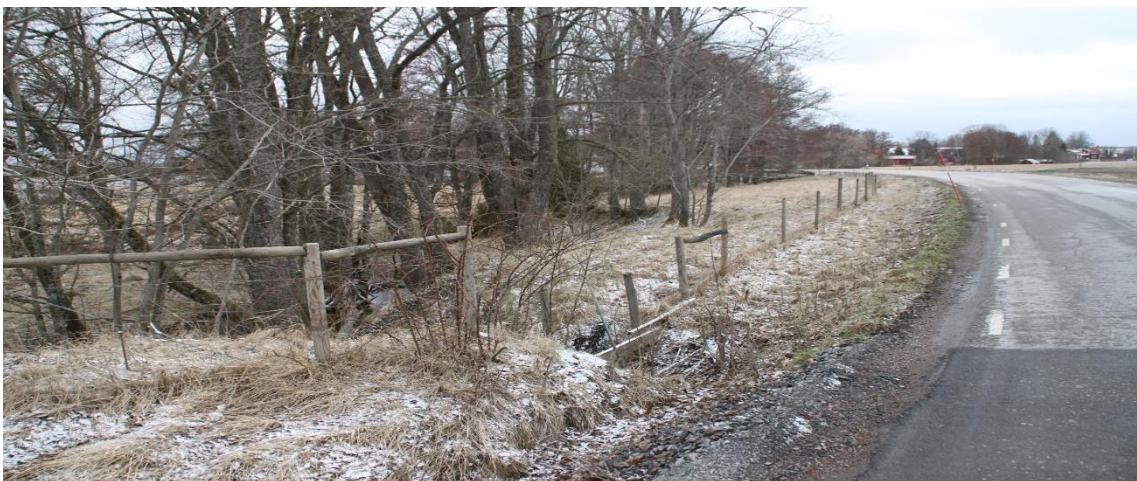
Figur 28. Exempel på situation där vägen borde vara utrustad med räcke, situation 1 väg 631.
