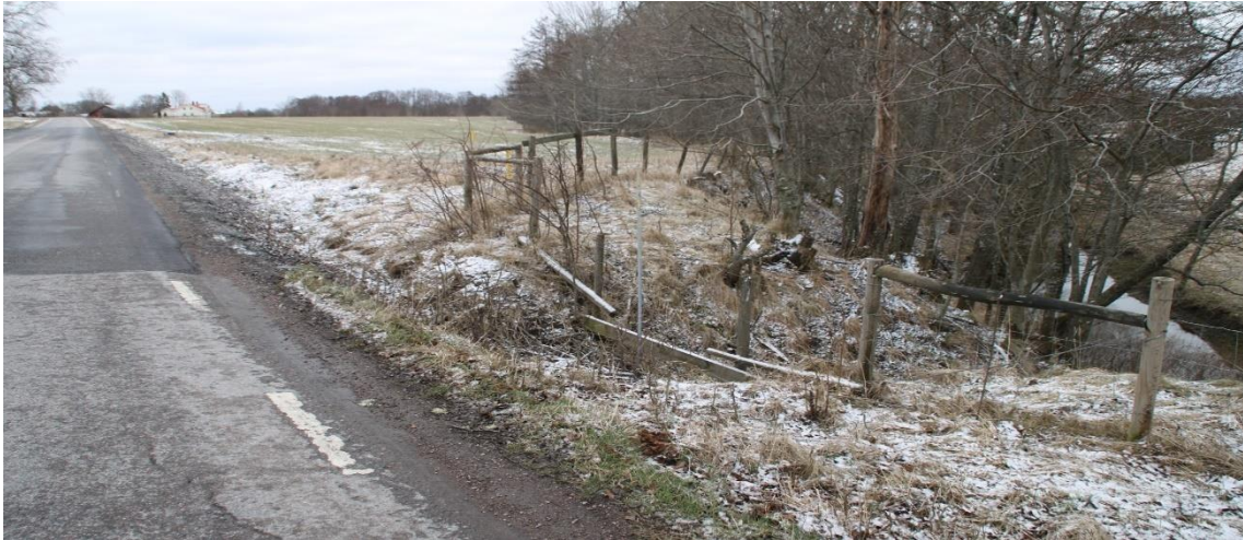
Figur 29. Exempel på situation där vägen borde vara utrustad med räcke, situation 1 väg 631.
