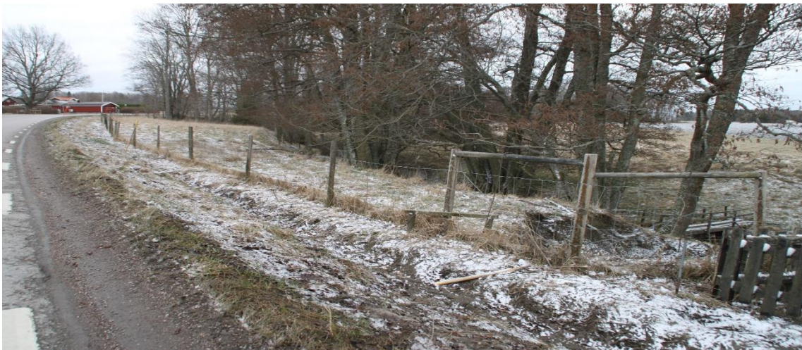
Figur 30. Exempel på situation där vägen borde vara utrustad med räcke, situation 1 väg 631.
