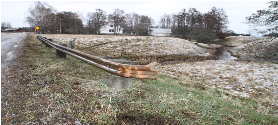
Figur 24. Exempel på vägräckesände som inte uppfyller de nuvarande standarderna, situation 2 väg 631.
