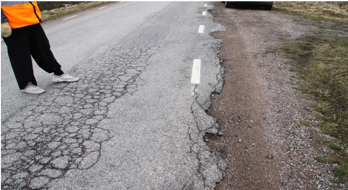
Figur 39. Exempel på trasig beläggning och stödremsa på vägen, situation 4 väg 631.
