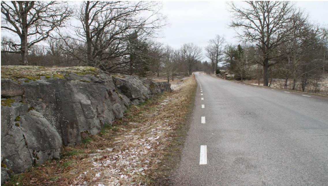
Figur 15. Exempel på klippblock i sidoområdet, situation 6 väg 631.
