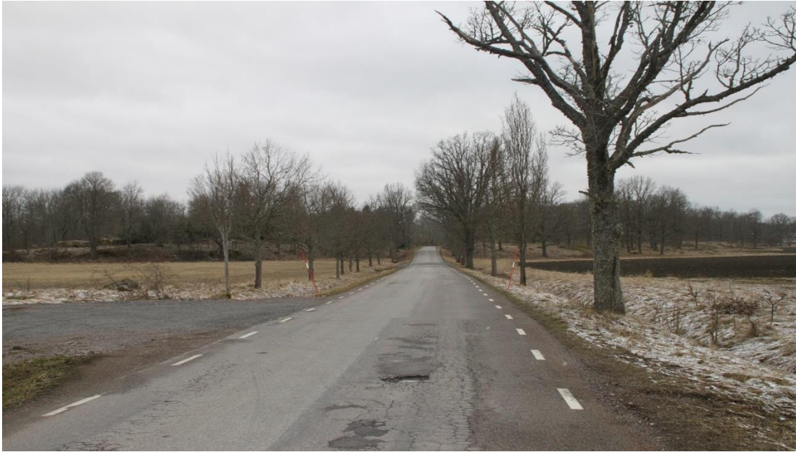
Figur 14. Exempel på alléträd, situation 5 väg 631. Beläggning i dåligt skick med bland annat potthål kan även ses i figuren.
